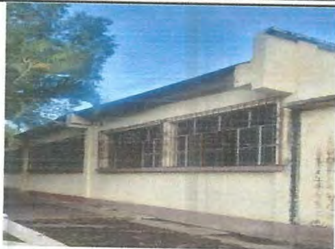
Foto 1: Será necesario realizar el cambio de cubierta de duralita debido que es un material dañino para la salud.
