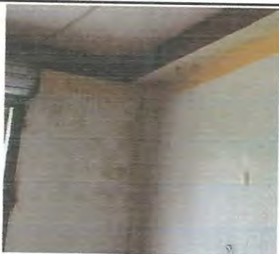
Foto 3: Se observa la filtración de agua por el mal estado del techado.
