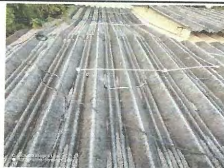
Foto 6: La instalación eléctrica se encuentra expuesta por lo que es un peligro para la comunidad educativa.
