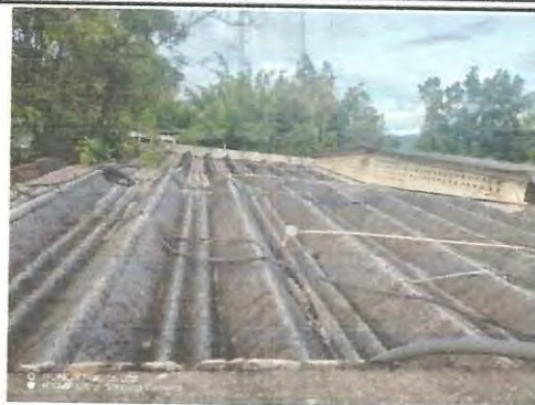
Foto 2: La duralita ya se encuentra en mal estado por el tiempo que lleva en uso.
