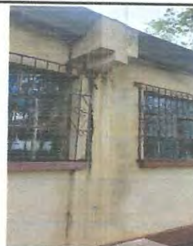
Foto 4: La canaleta se encuentra obstruida por acumulación de desechos naturales que por muchos años no se ha limpiado debido que el techo no cuenta con estructura metálica.
